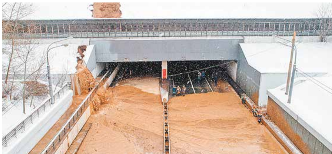
В январе 2019 года Тушинский тоннель был затоплен из-за размыва насыпи канала им. Москвы
