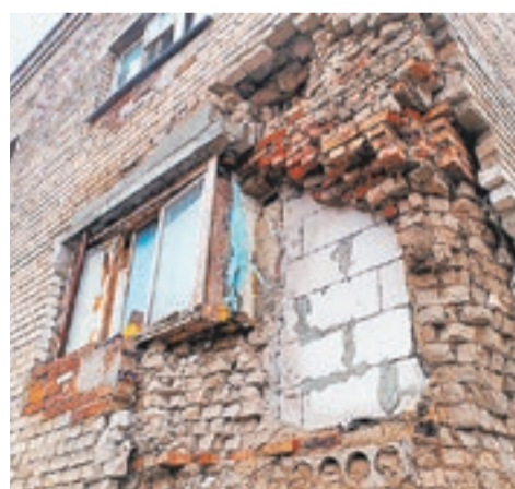
Аварийный дом в Пензе
